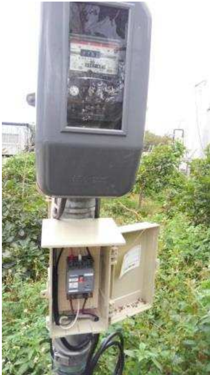
電力量計は、AC200V 及び 100V について現場内の一号柱に設置した。
