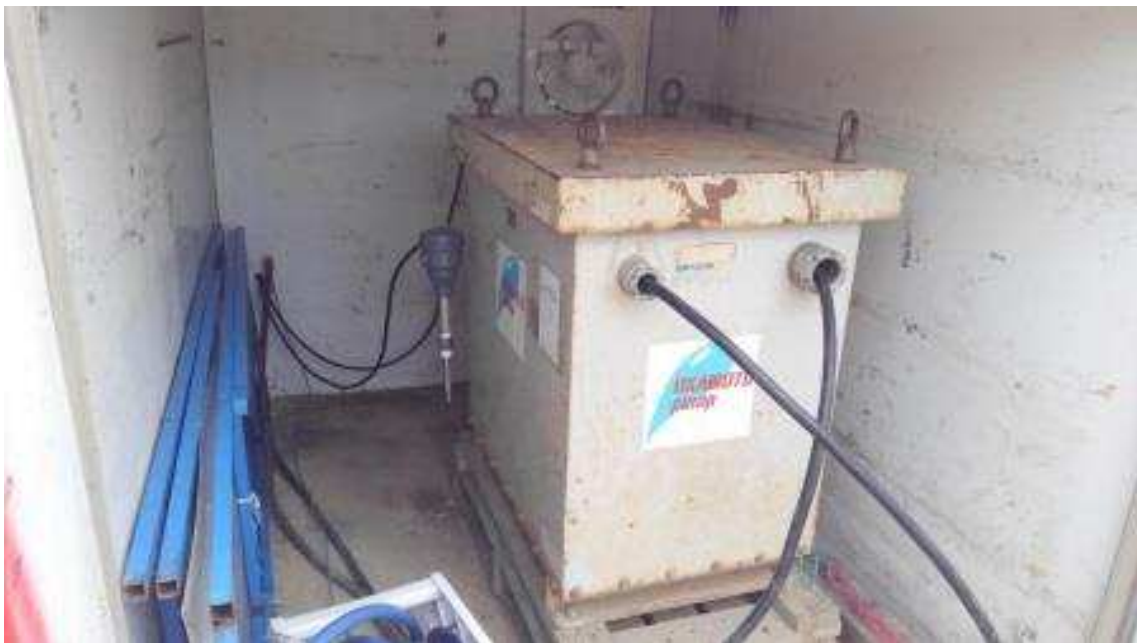
昇圧トランス
